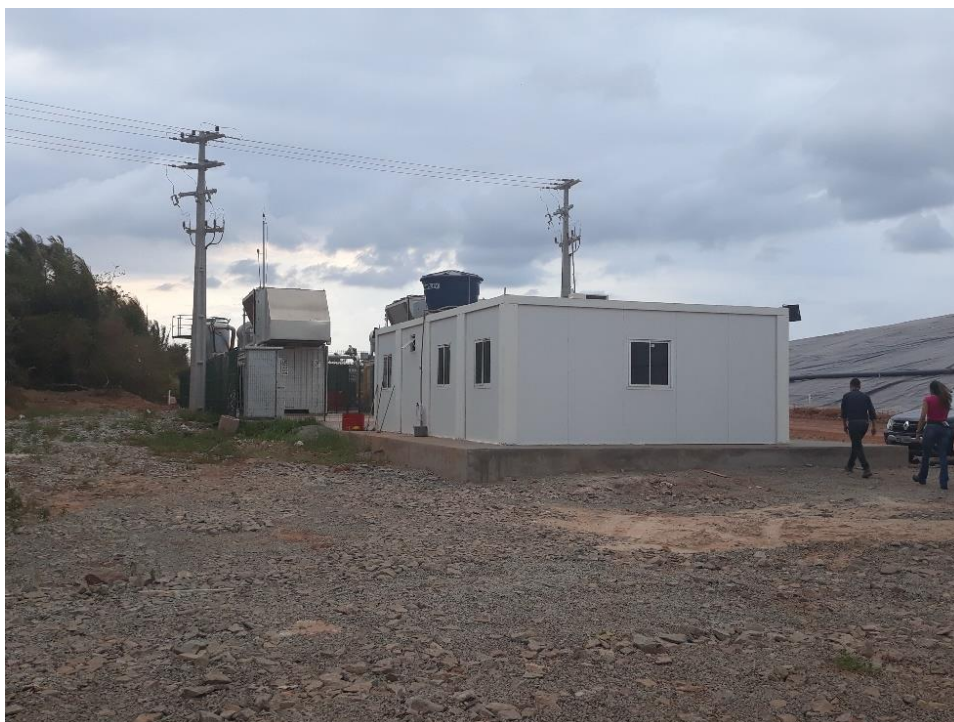
Figura 17 - Usina de geração de energia a partir do biogás captado do aterro Fonte: Ibict (2019)
