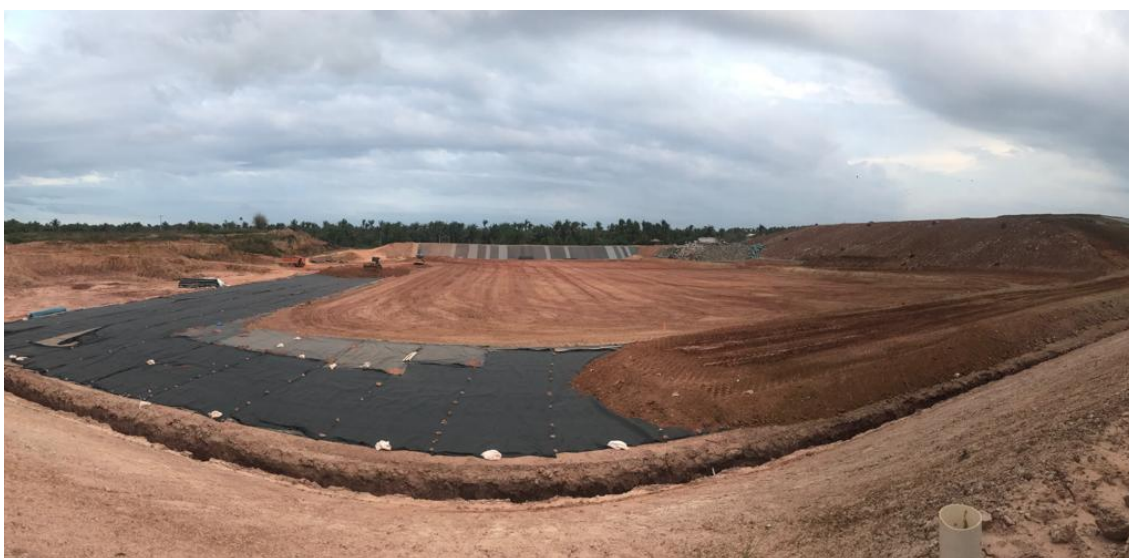
Figura 16 - Vista da célula do aterro sanitário e industrial – CL II Fonte: Ibict (2019)
